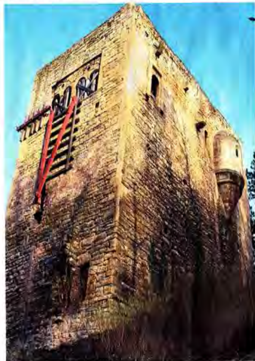
Noch wird diese Mauer des Palas nur mit einer provisorischen Klammer zusammengehalten. Doch immer dringlicher wird eine richtige Sanierung. Foto: Michael Groß
